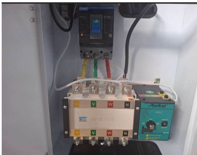
Fig 1. Muestra de Cableado de Fuerza.
